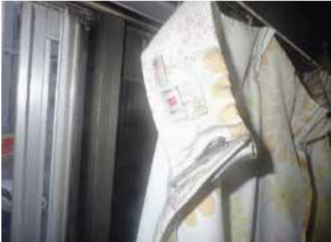
奏功事例① 延焼拡大を抑制した防災カーテン
