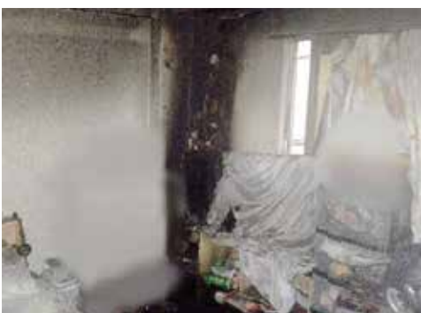
奏功事例① 天井高さまで焼損した室内。隣接する防災カーテンに大きな焼損は見られない。
